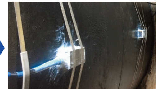
取付け後のセンサーの外観 検出器は大口径用C110オプションを使用
